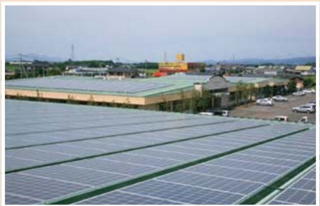
施設の屋根に設置された太陽光パネル
